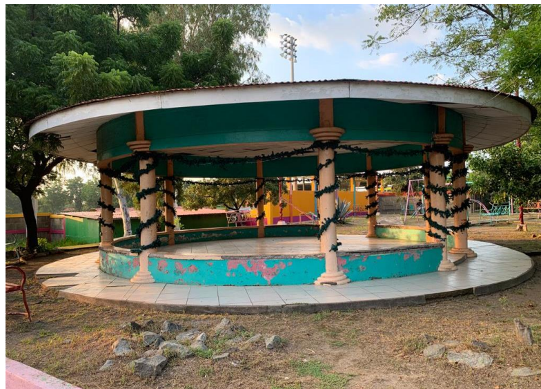
Nota 30 El mantenimiento superficial en las infraestructuras cada vez se nota más. Adaptado de (Fuente: Elaboración propia)
