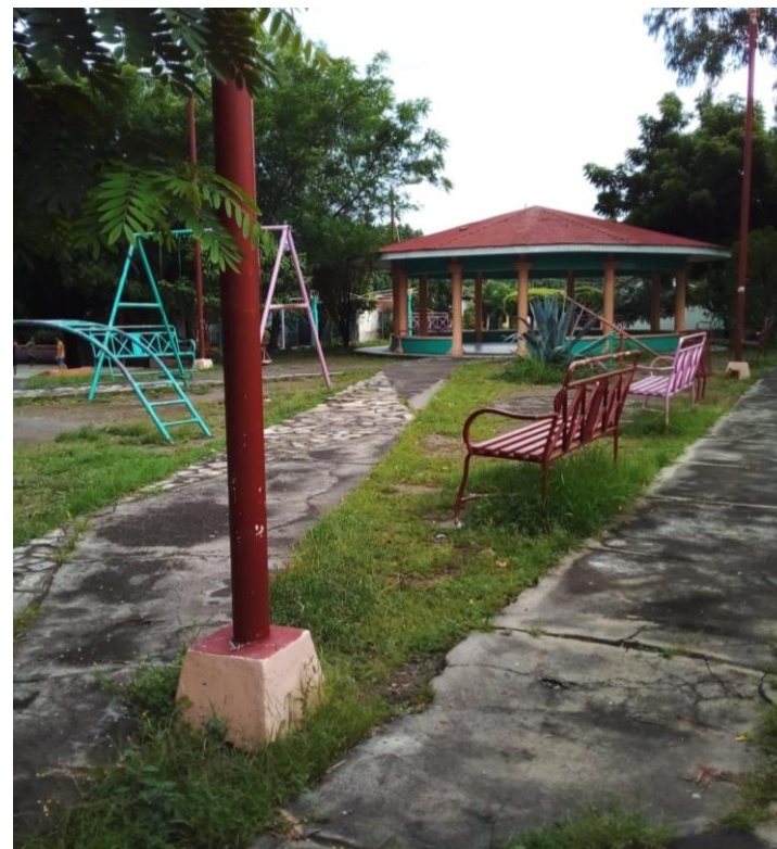
Nota 35 El deterioro continuo de este espacio solo profundiza el distanciamiento de la comunidad, lo que con el tiempo contribuye a su deterioro aún mayor. Adaptado de (Fuente: Elaboración propia)
