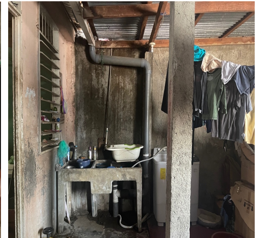
Imagen #23: Manchas por humedad en la pared del lavadero
