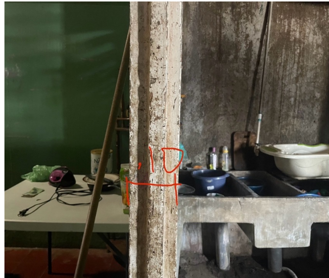
Imagen #24: Eflorescencias, fisuras y manchas por humedad
