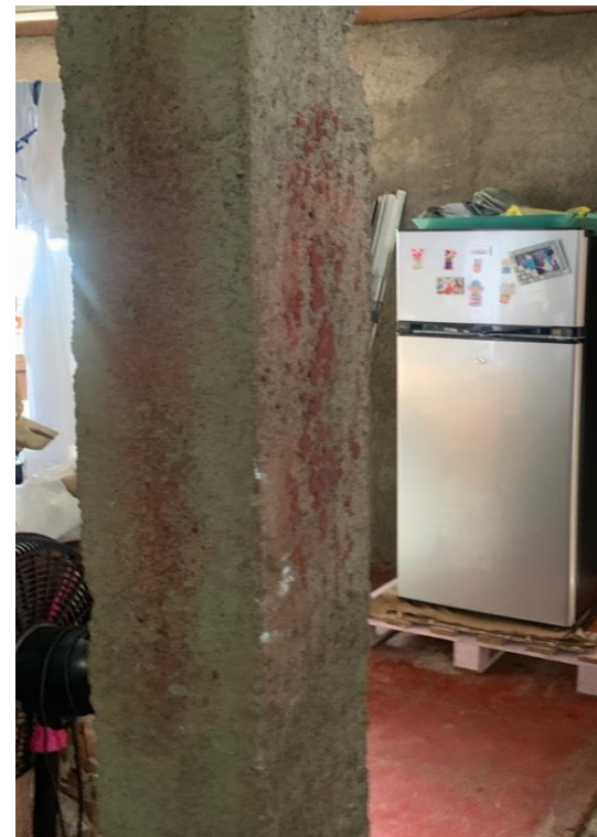
Imagen #22: Eflorescencia y fisuras en las columnas
