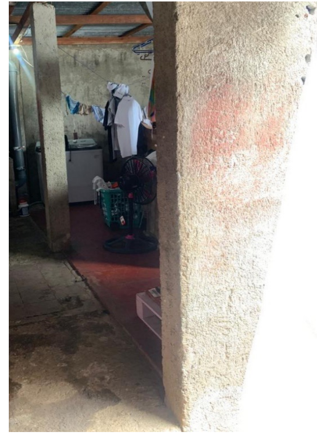
Imagen #27: Hundimiento del piso, manchas en las paredes y desniveles de piso.
