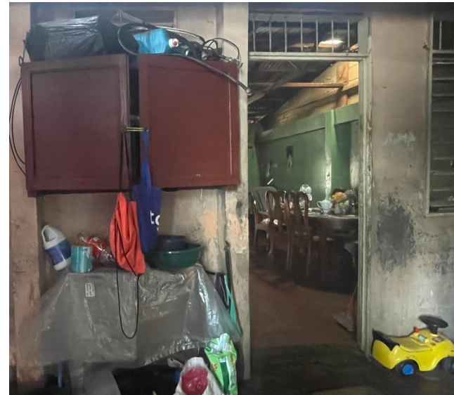
Imagen #25: Grietas y deformaciones, corrosiones, por metales oxidados
